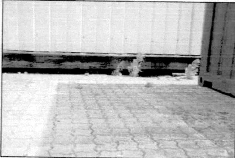
Poškození zpevněných ploch
