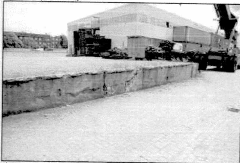
Poškození nákladových ramp
