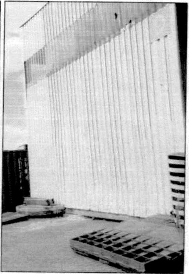
poškození pláště skladové haly
