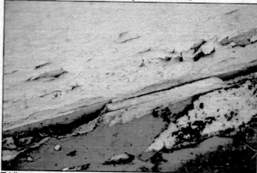
Trhliny v patě domu
