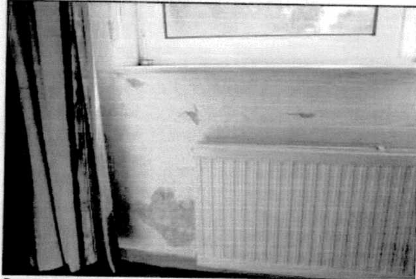
Opravy nutné v bytech - zatékání
