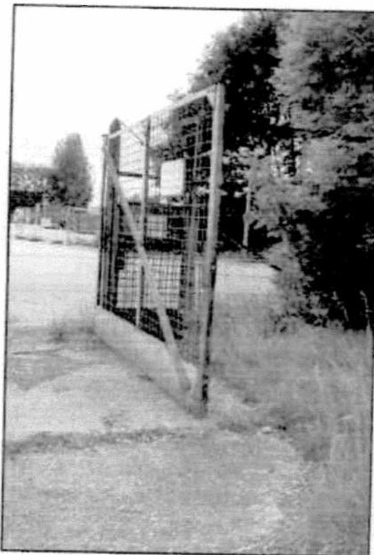
Oplocení, vrata – nefunkční, zkorodované
