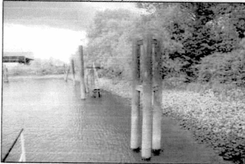
Đalby a piloty, včetně lávky – nutná sanace či odstranění
