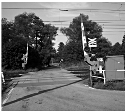
Obr. č. 3: Zařízení PZS se závorami typu SSSR
