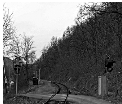
Obr. č. 5: Zařízení PZS typu VÚD s pozitivní návěstí. Reléová logika umístěna v plechové skříní v těsné blízkosti přejezdu.
